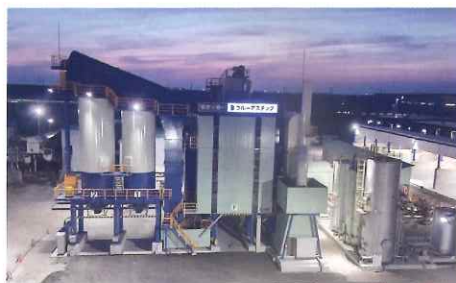
GXプラント施工例「ブルーアステック(石川県川北町)」
